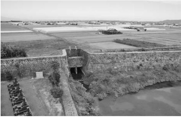
写真 45 末広開二枚戸樋門（東から）
