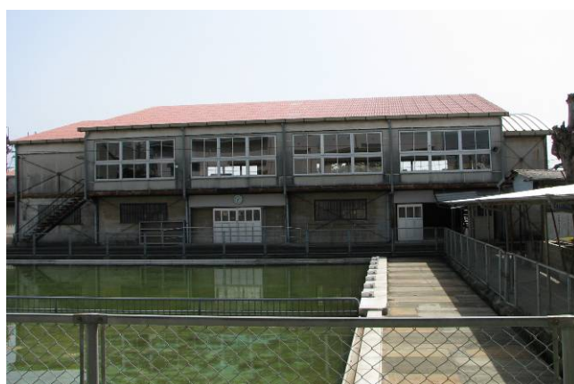
老朽化した玉名町小学校体育館・プール
