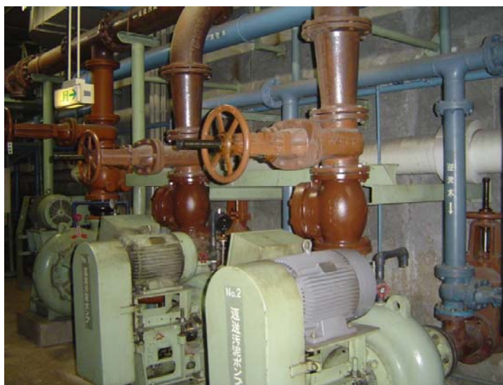
玉名市浄化センター内機械設備
