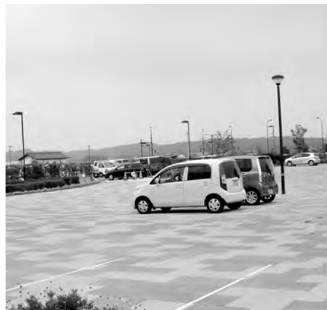
▲傷んでいる市民広場の敷設ブロック
