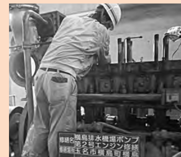
▲運転稼働中に故障した横島排水機場ポンプ。早急に修繕が行なわれた
