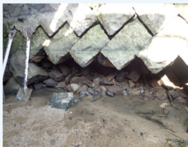
水替え後の洗堀状況
