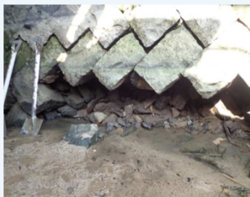
水替え後の洗堀状況
