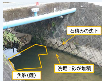
水位が下がり魚影により洗堀確認状況
