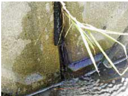
▲唐人川堤防の水漏れ
