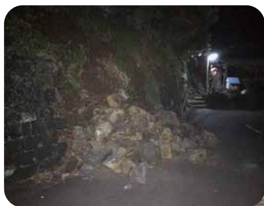
熊本地震で崩壊した天水地区 北横内の石垣 (地震発生直後)
