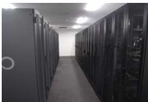
情報システムの機器等を設置するサーバ室
