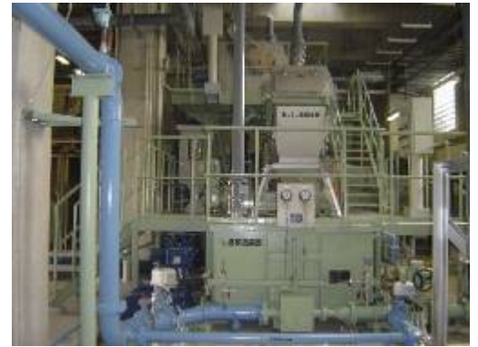
玉名市浄化センター内汚水処理施設
