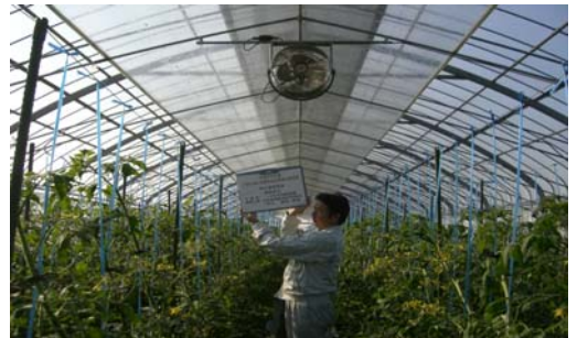
ハウス内循環扇(省エネルギー施設)
