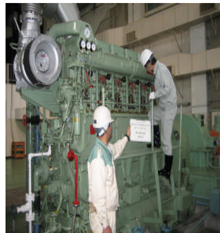
玉名市浄化センター内汚水処理施設
