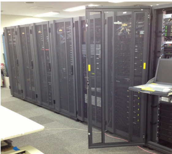
様々な市民サービスを提供する システムサーバ群
