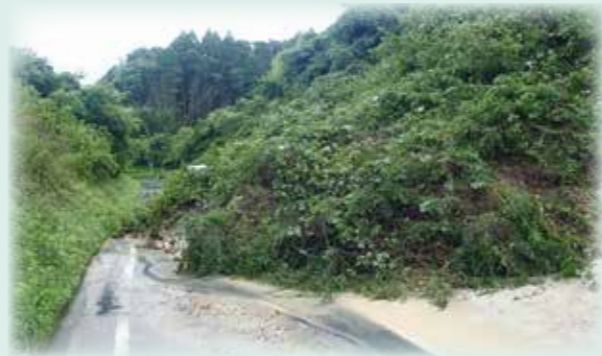
小岱山防火林道(石貴側)法面崩落
