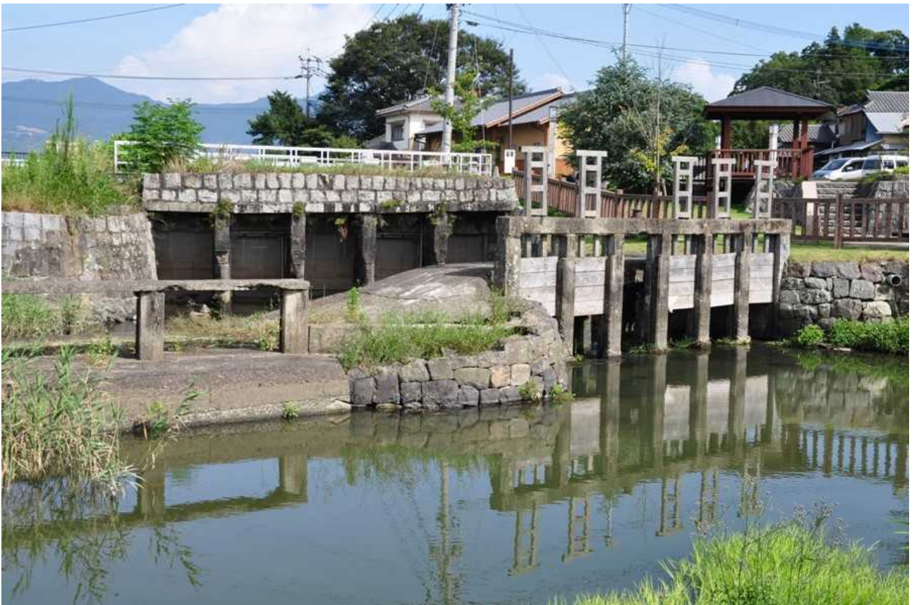
石塘の樋門群。奥が新内井樋、手前右が六枚井樋、左が越堰。
