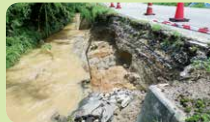
箱谷月田線の路肩が崩壊
