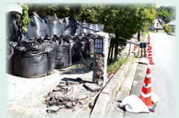
▲地滑りにより歩道が破損した部分
