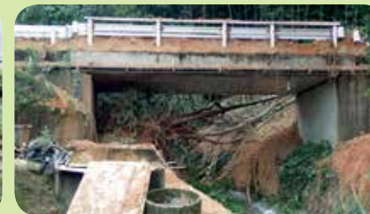
土砂が崩れ橋に覆いかぶさった林道石尾線石尾小代橋
