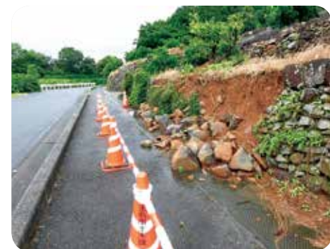
▲八嘉小通学路にある崩落箇所
