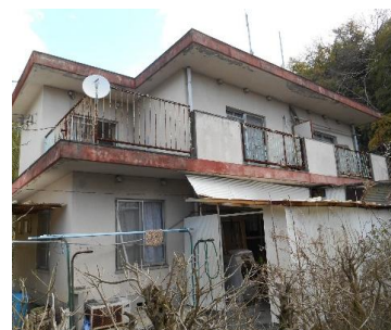
外壁が劣化した団地
