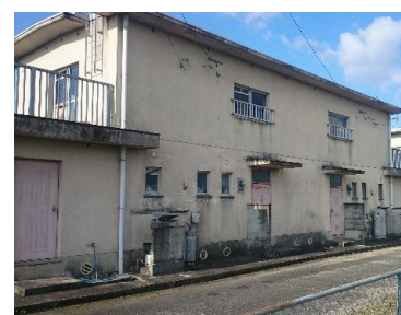
外壁が劣化した団地
