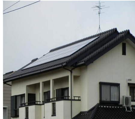
市内における太陽光発電システムの設置例
