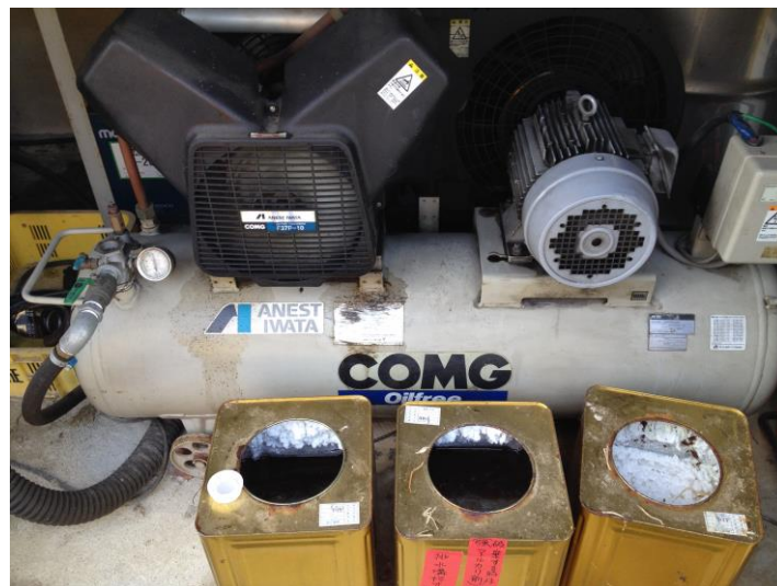
規制対象の一つである空気圧縮機（コンプレッサー）
